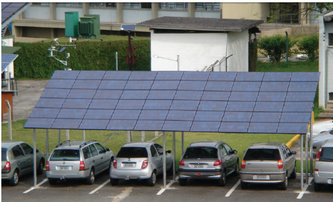
Figura 5 – Gerador fotovoltaico do sistema híbrido do LSF/IEE-USP.
