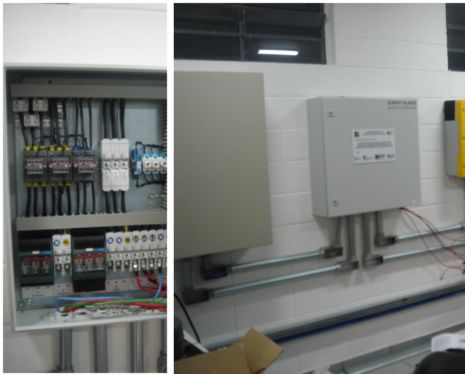
Figura 4 – Inversores bidirecionais, quadros de seccionamento, medição e proteção da minirrede do LSF/IEE-USP.
