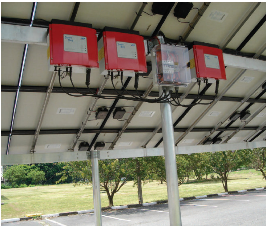
Figura 6 – Inversores c.c./c.a. de conexão à rede que compõem o sistema híbrido do LSF/IEE-USP.
