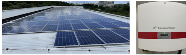
Figura 1 - Arranjo contendo Módulos Fotovoltaicos modelo CS3W-415P e Inversor Trifásico modelo CSI-30KTL-GI-L
