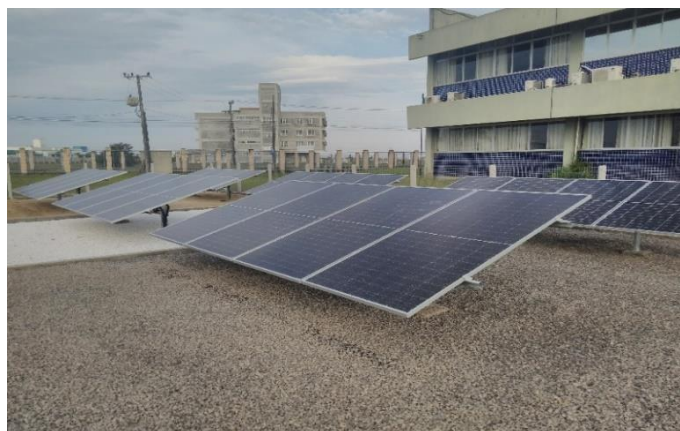
Figura 1 – Planta solar com módulos fotovoltaicos bifaciais e monofaciais.
