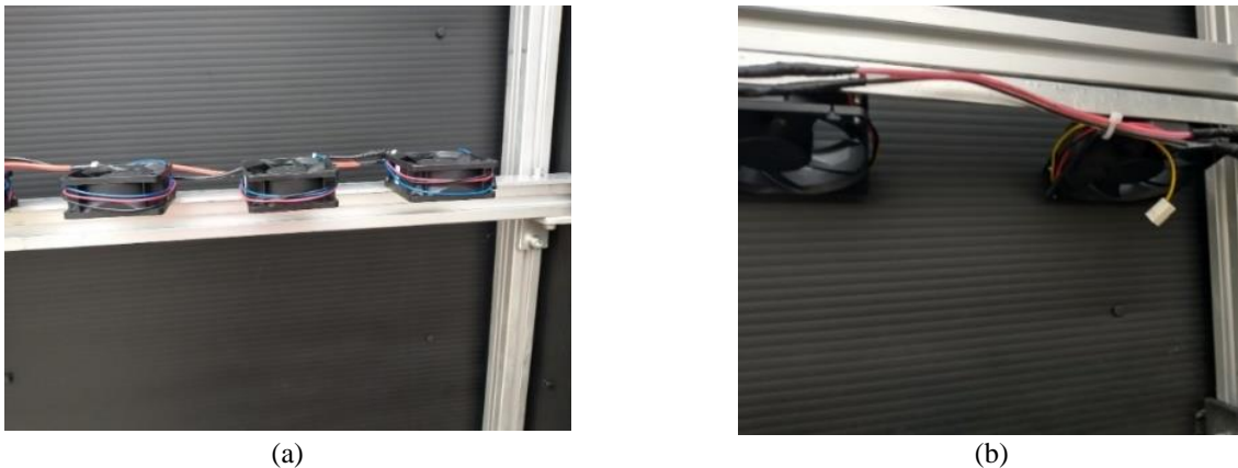
Figura 2– Instalação dos ventiladores aos longo dos perfis horizontais internos, sendo em (a) os ventiladores superiores e em (b) os ventiladores inferiores
