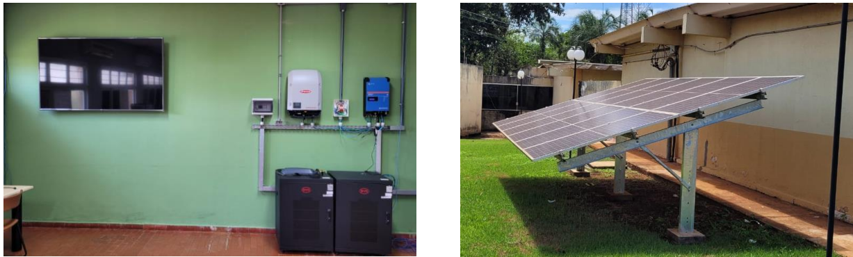
Figura 2 – Sistema Híbrido com banco de baterias de lítio
