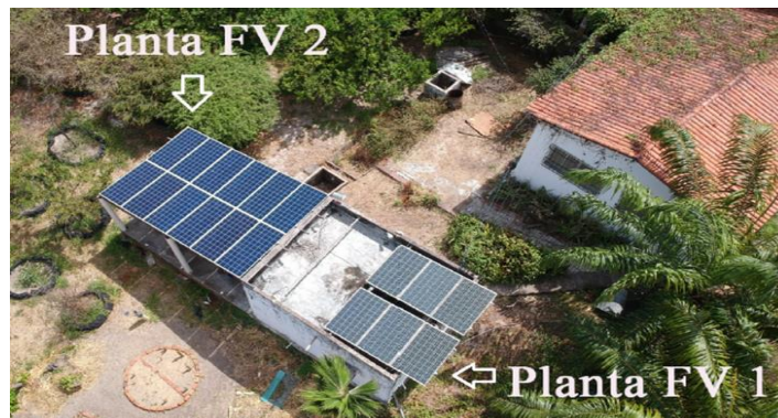
Figura 1 – Plantas FV instaladas no LEA - UFC.
