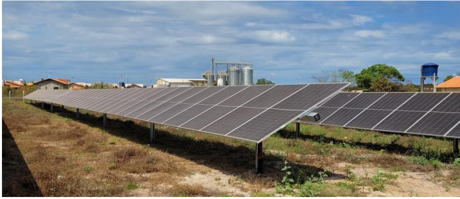
Figura 3: Miniusina de geração solar fotovoltaica (GD Nova Longá), instalada no município de Altos-PI. Fonte: Elaborado pelo autor.
