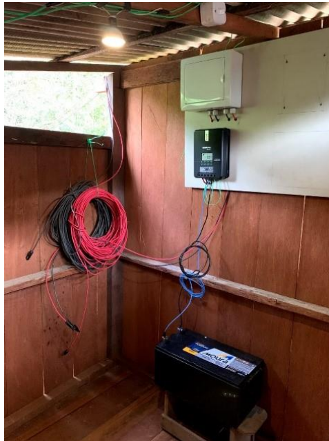
Figura 10 – Alojamento do sistema de controlador e bateria da THC de Cachoeira do Mentae.
