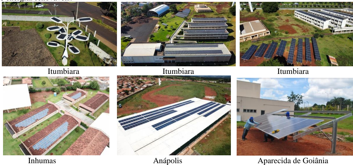
Figura 1 – Fotos das usinas e árvores fotovoltaicas instaladas em alguns câmpus do IFG.
