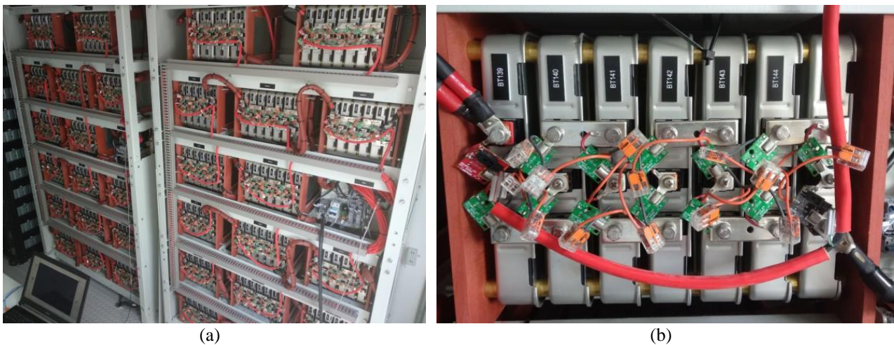
Figura 2 - (a) Racks de baterias em segunda vida; (b) Conjuntos de baterias em segunda vida (Hohmann et al. , 2022).
