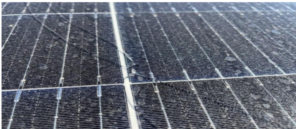
Figura 6 – Trinca encontrada em um dos módulos da usina FV durante a Fase 1 do estudo.
