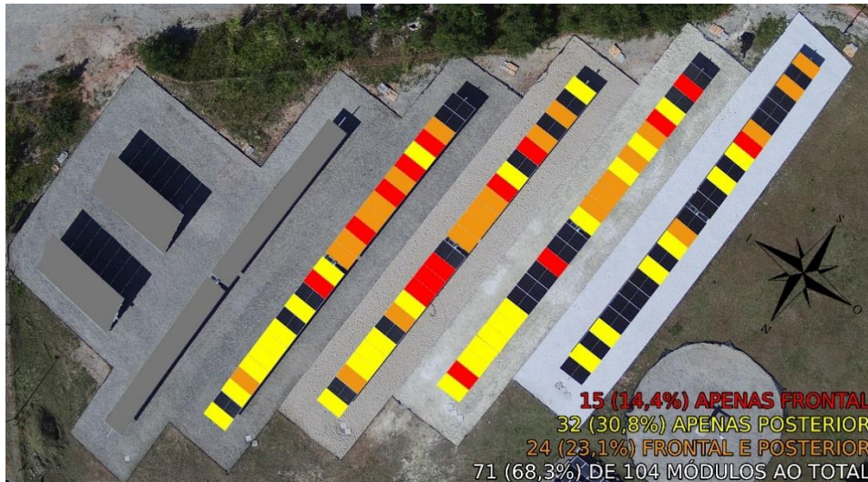
Figura 5 – Imagem aérea da usina FV destacando os módulos trincados analisados na Fase 1 deste estudo de caso. Módulos com o vidro frontal quebrado são representados em vermelho, enquanto trincas no vidro posterior estão em amarelo e módulos com trincas em ambos os lados são destacados em laranja. O texto da imagem traz o número total de módulos trincados e o valor porcentual em relação ao número total de módulos da planta.
