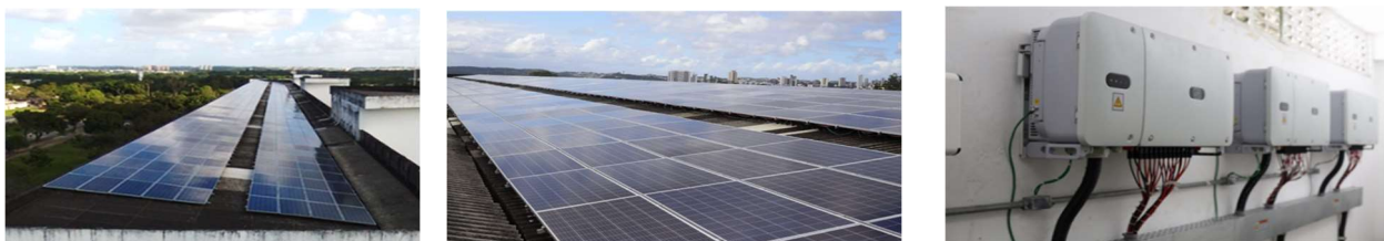
Figura 1 – Vista geral do arranjo (792 módulos); Sombreamento por nuvens; Grupo de inversores (3x60kW).
