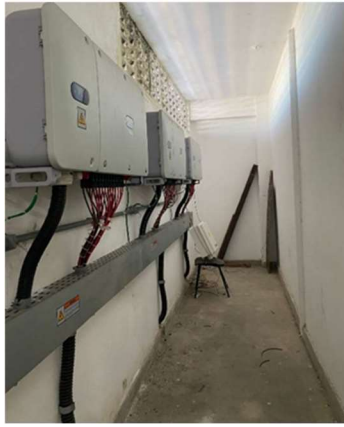
Figura 12 - Imagem do local de instalação dos inversores do Sistema CTG.
