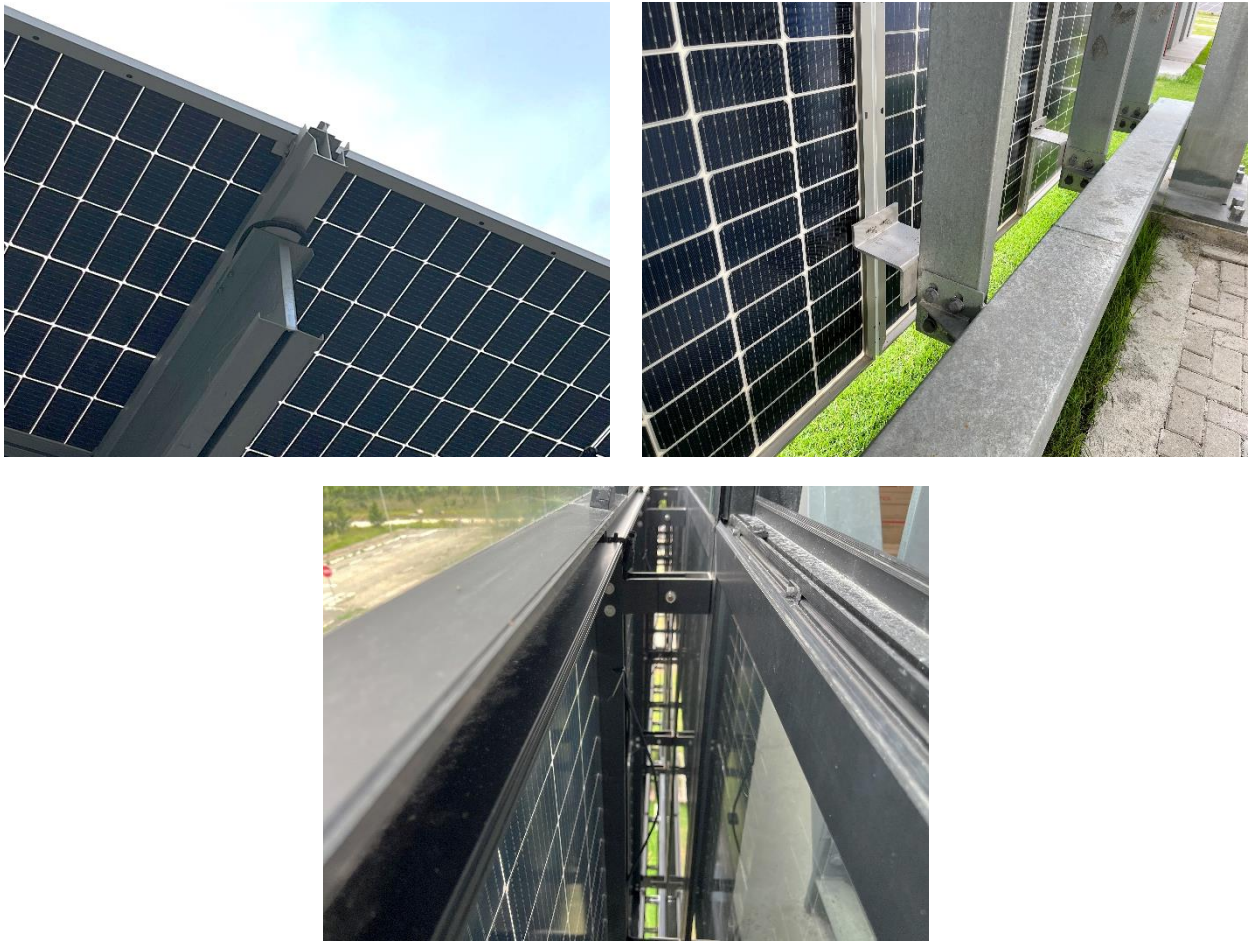
Figura 2 – Fixação dos sistemas de cobertura C1 e C2 (superior esquerda), de fachadas F1 e F2 (superior direita) e de brises B1-B6 (inferior) do Bloco C do Laboratório Fotovoltaica/UFSC.
