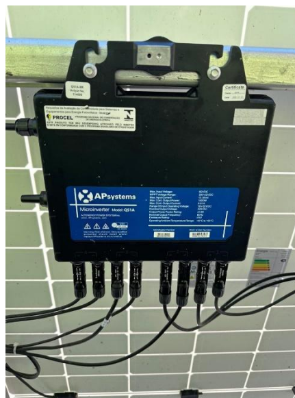
Figura 4 – Vista do microinversor fixado na estrutura dos módulos FV.
