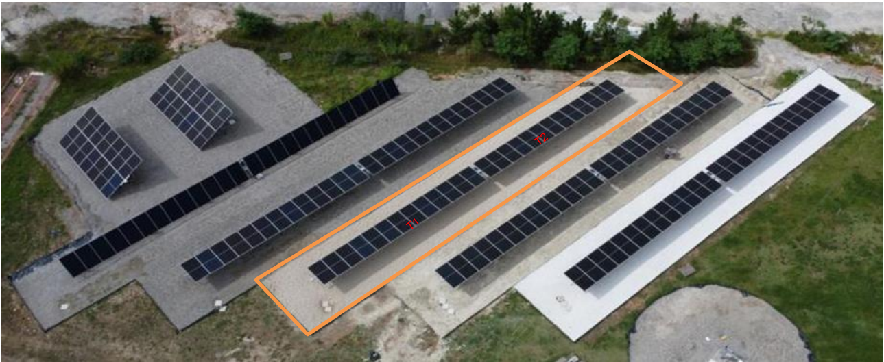
Figura 1 – Imagem aérea da usina fotovoltaica piloto localizada na sede do laboratório Fotovoltaica/UFSC em Florianópolis-SC (27,43°S, 48,44°O) com destaque para o subsistema analisado neste trabalho. O Norte está apontado aproximadamente para o canto inferior esquerdo da imagem.
