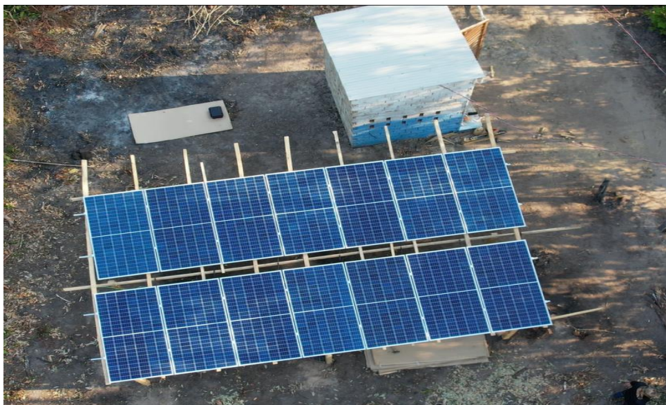
Figura 4 – Gerador Fotovoltaico instalado em sua estrutura.
