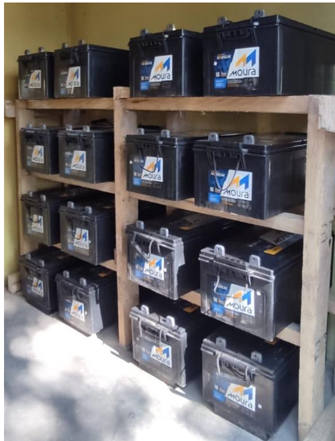
Figura 6 – Banco de Baterias não conectado.
