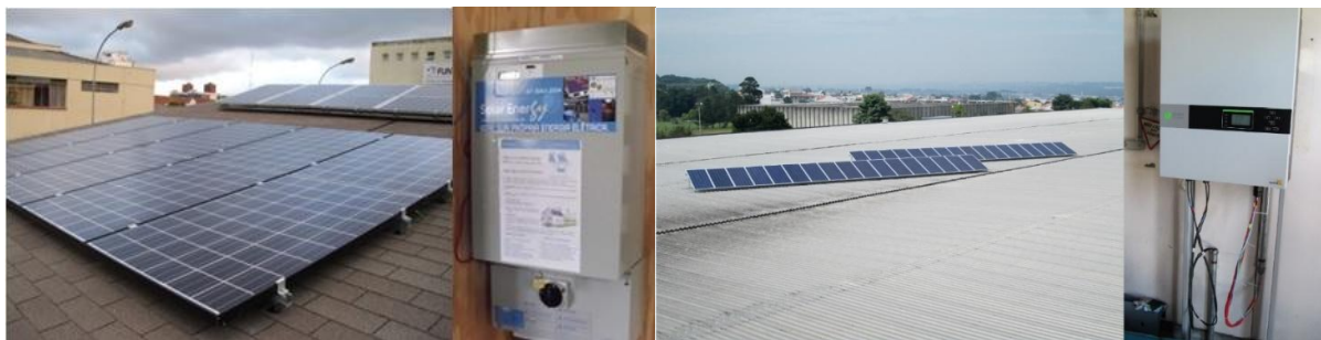
Figura 1 – Vista dos Painéis do EV e do Inversor - Sede Centro (a) e do SFVCR e do Inversor – Sede Neville (b) Fonte: Urbanetz Jr et al. (2014), Mariano et al. (2016) (Urbanetz Jr et al. , 2016).
