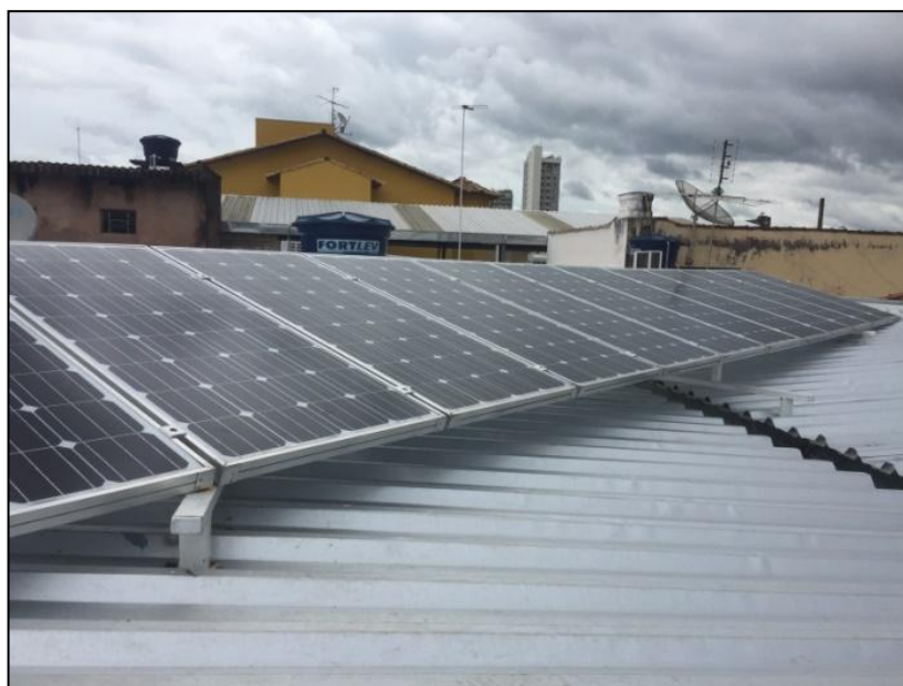
Figura 2 – Gerador fotovoltaico após comissionamento.
