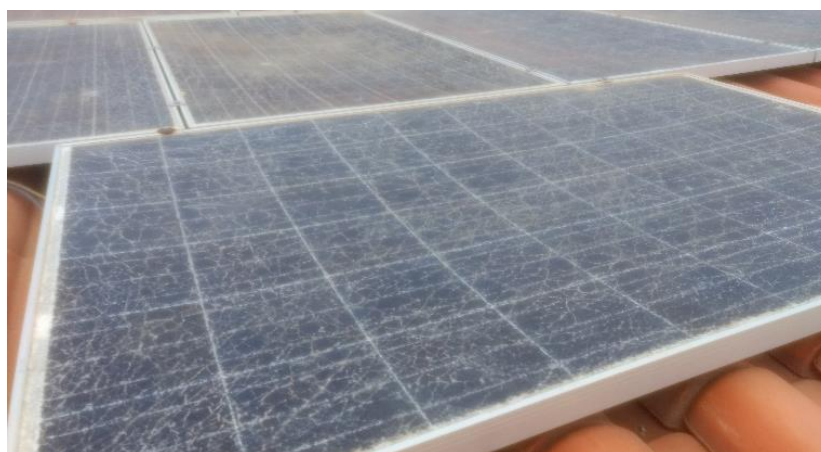
Figura 7 - Painéis fotovoltaicos danificados.
