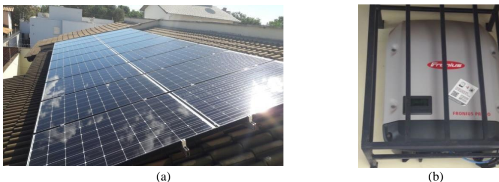
Figura 2 - (a) Módulos fotovoltaicos no telhado; (b) Inversor monofásico de potência 5 kW.
