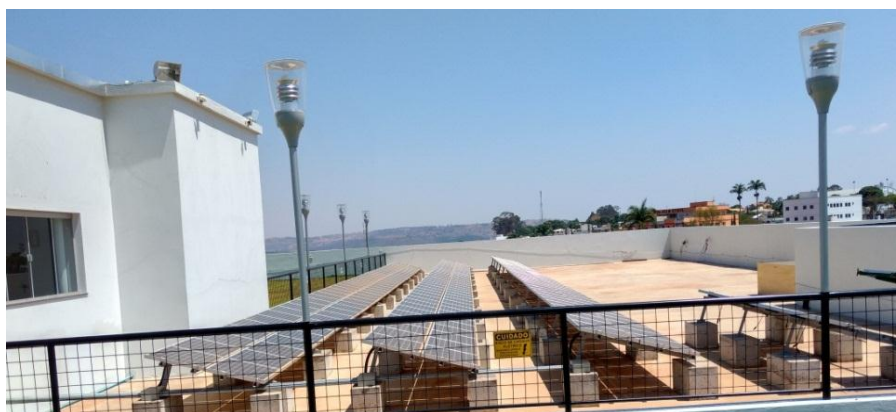
Figura 3 - Micro usina fotovoltaica UNIPAM
