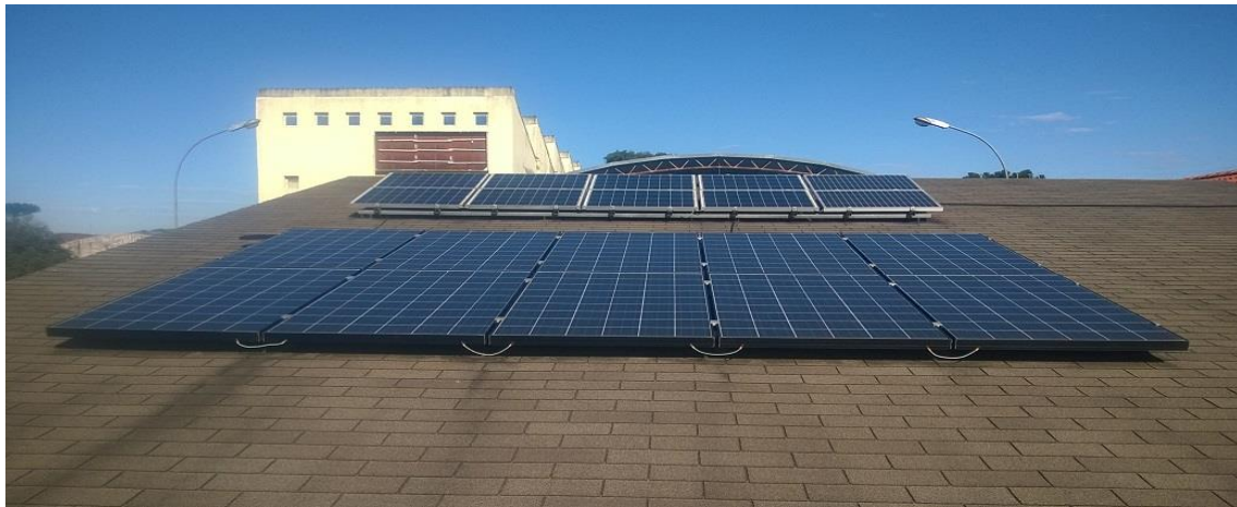
Figura 1 - Paineis fotovoltaicos do EV.
