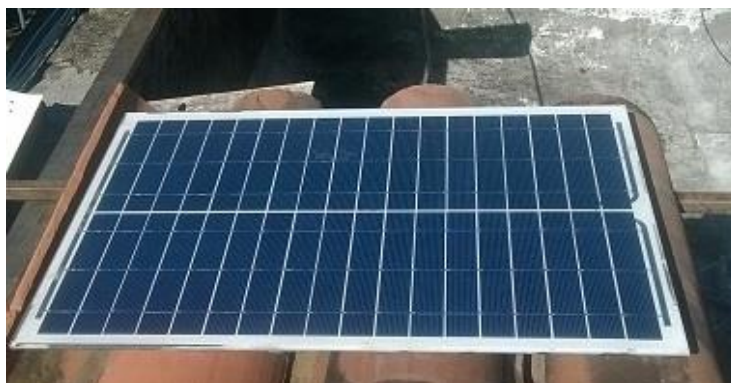
Figura 6 – Módulo FV sobre o telhado.
