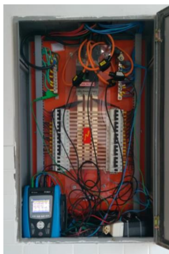
Figura 6 – Alocação do analisador de energia elétrica no quadro de proteção do bloco de salas de aula dois (2) da UFERSA Campus Caraúbas.
