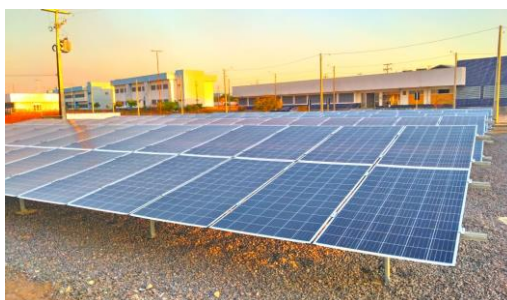
Figura 1 – Usina solar de 62,7 kWp da UFERSA Campus Caraúbas.
