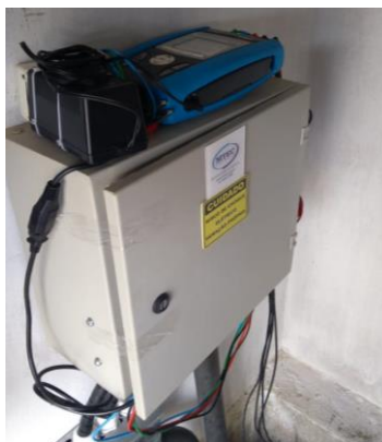
Figura 5 – Alocação do analisador de energia elétrica no quadro de proteção da usina solar da UFERSA Campus Caraúbas.
