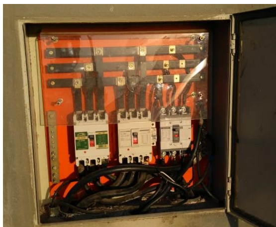
Figura 3 – Quadro de distribuição da subestação aérea simplificada do bloco de salas de aula dois (2) da UFERSA Campus Caraúbas.
