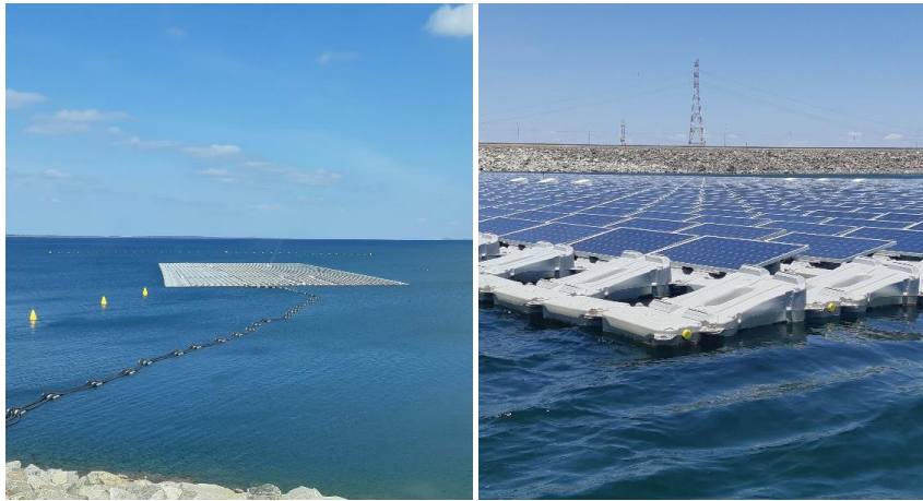
Figura 8 - Usina FVF no reservatório da UHE Sobradinho. Fonte: visita técnica EPE em 10/2019
