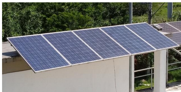
Figura 1 – Instalação fotovoltaica avaliada.
