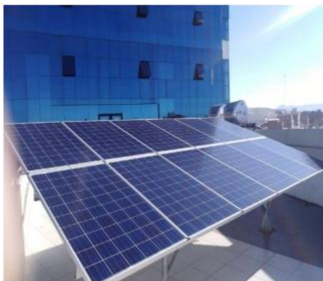
Figura 1 – Gerador fotovoltaico instalado no pavilhão administrativo da UNAJ.
