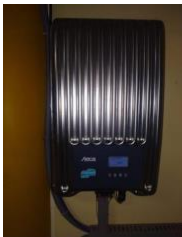
Figura 2 – Inversor instalado no laboratório de controle e automação no pavilhão administrativo da UNAJ.
