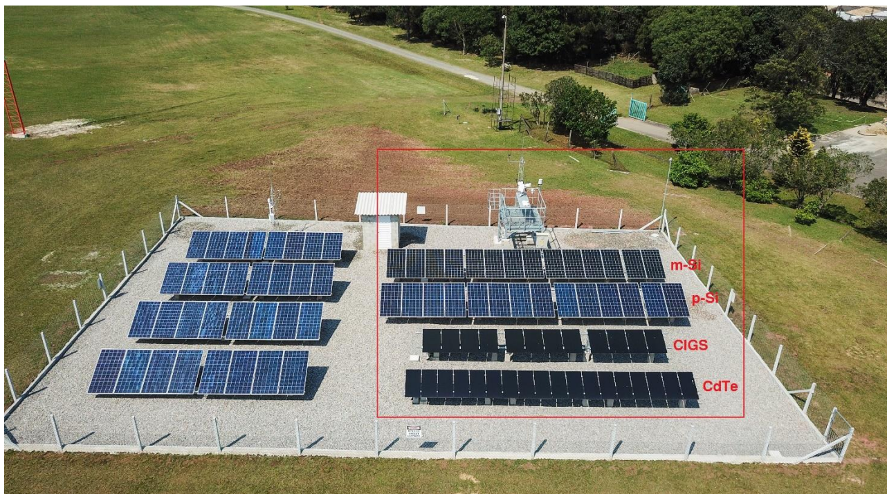
Figura 1 – SFCR com diferentes tecnologias e estação SONDA destacados em vermelho. As quatro fileiras de geradores fotovoltaicos, correspondem às tecnologias de: m-Si, p-Si, CIGS e CdTe.
