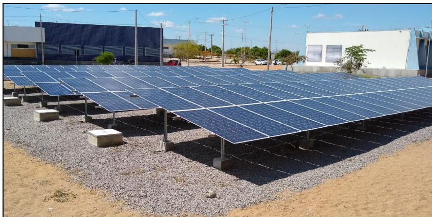
Figura 1 – Usina Solar Fotovoltaica da Ufersa Campus Caraúbas.
