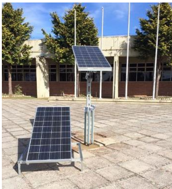
Figura 8 - Instalação do módulo fixo ao lado do seguidor
