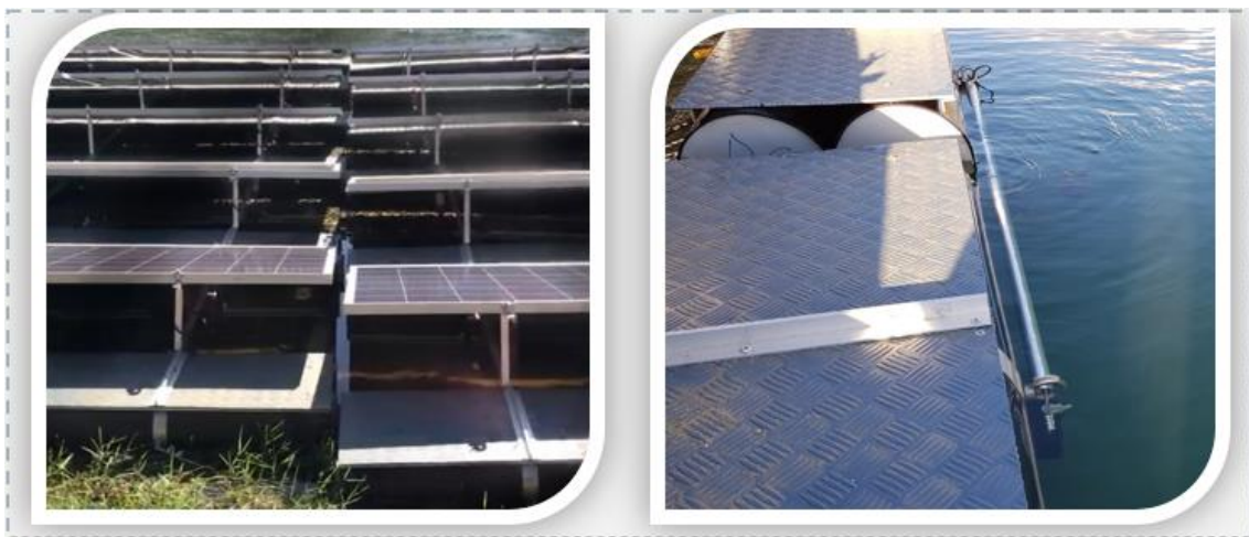
Figura 8 – Detalhe do problema de alinhamento entre os blocos.
