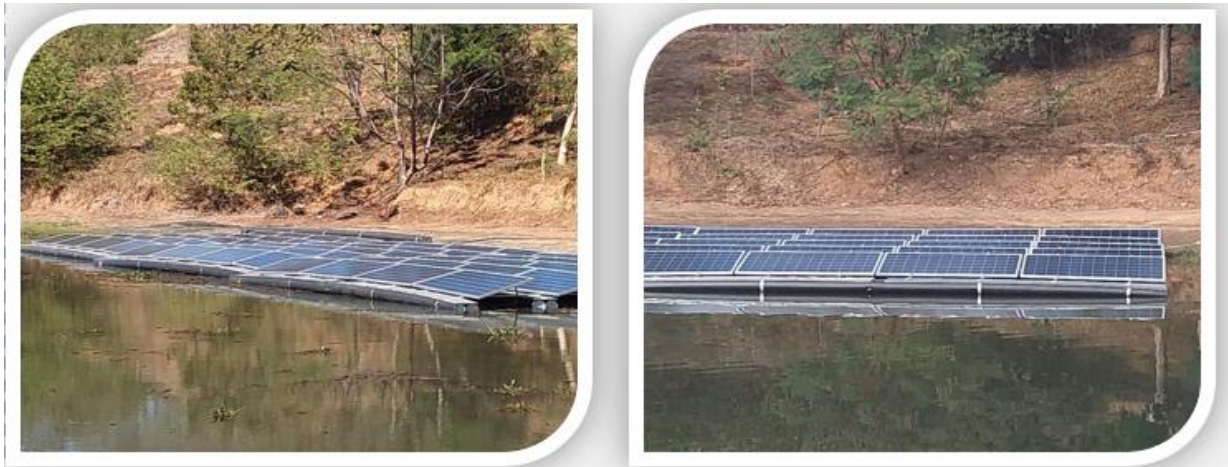
Figura 9 – Detalhe do problema de curvatura dos flutuadores principais.
