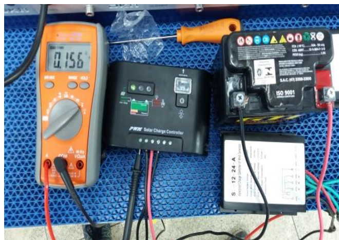
Figura 6 – Medição da corrente gerada pelo aerogerador.
