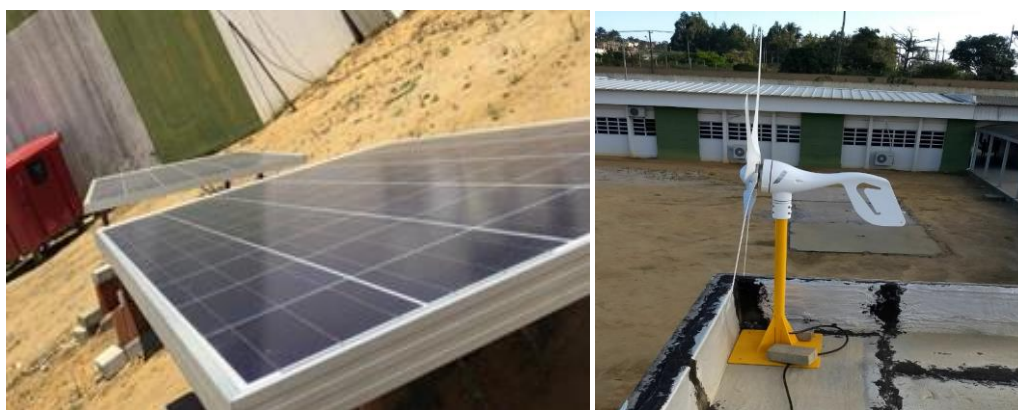
Figura 5 – Aerogerador e placas solares instaladas.
