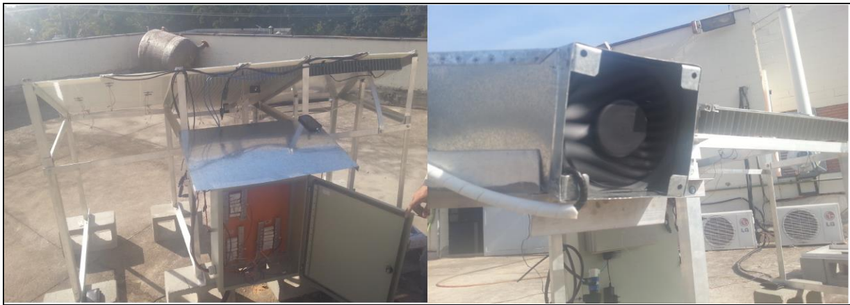
Figura 2- Montagem completa dos módulos com dissipadores.
